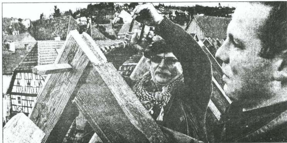
DACHSANIERUNG WIE ANNO DAZUMAL am ältesten Fachwerkhaus in Ellmendingen. Nur mit „Schere und Zapfen“ wird der Dachstuhl aufgeschlagen. Foto: Ossmann
