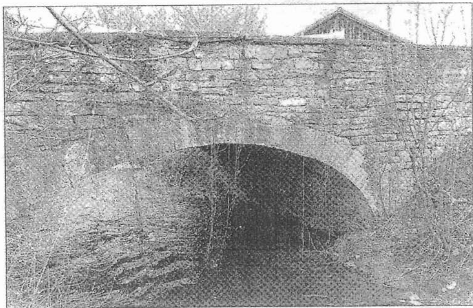
Die historische Gewölbebrücke gehört bald der Vergangenheit an. Der Neidensteiner Gemeinderat beschloss nun den Abriss des Bauwerks. Foto: Jürriens
