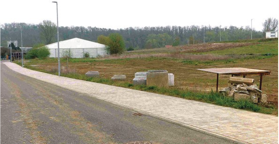
Bei den Erschließungsarbeiten zur Erweiterung des Gewerbegebiets wurden archäologische Funde freigelegt und dokumentiert.
